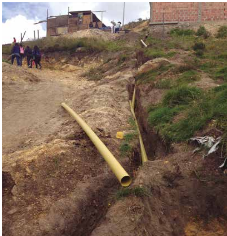
Construcción alcantarillado para aguas negras en Altos de la Florida (Pablo Cortés Ferrández) ►
